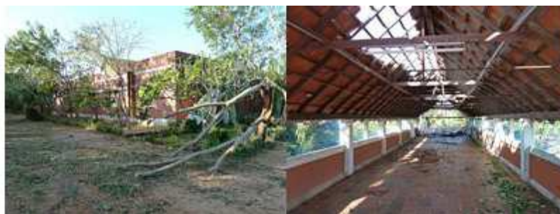
L'IITPD, gravement endommagé
